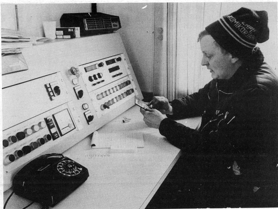
Betonin valmistus ohjataan kokonaan tämän pöydän äärellä. Kuvassa Sauli Hettula tekemässä betonia.
